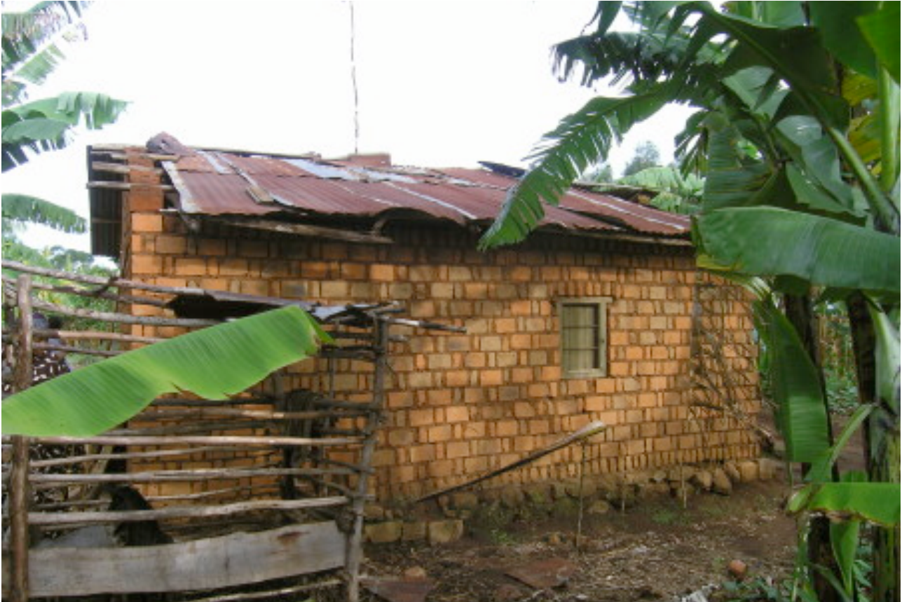
Auf blosser Erde ohne Decke: Schadhafes Haus der Geschwister ohne Eltern
